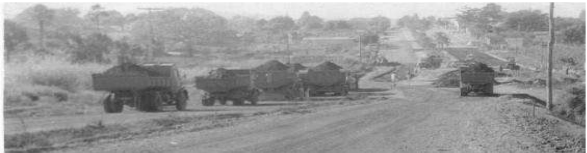
Figura 8 - Obras na construção da Avenida Hermógenes Coelho. Fonte: Biblioteca Pública de São Luís de Montes Belos
