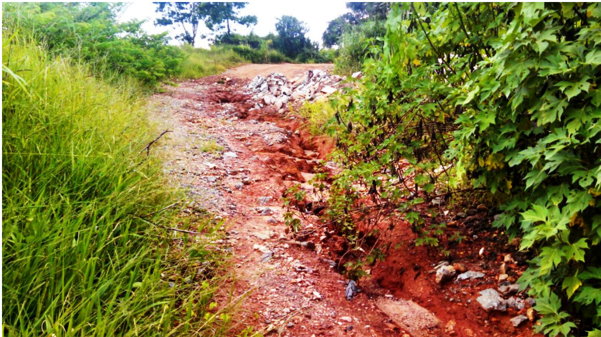
Foto 5 – Formação de sulco e ravina no sentido da declividade e em sentido ao leito do Córrego Santo Antônio, nas proximidades dos setores Cândido Queiroz e Maria Inês, Aparecida de Goiânia.
