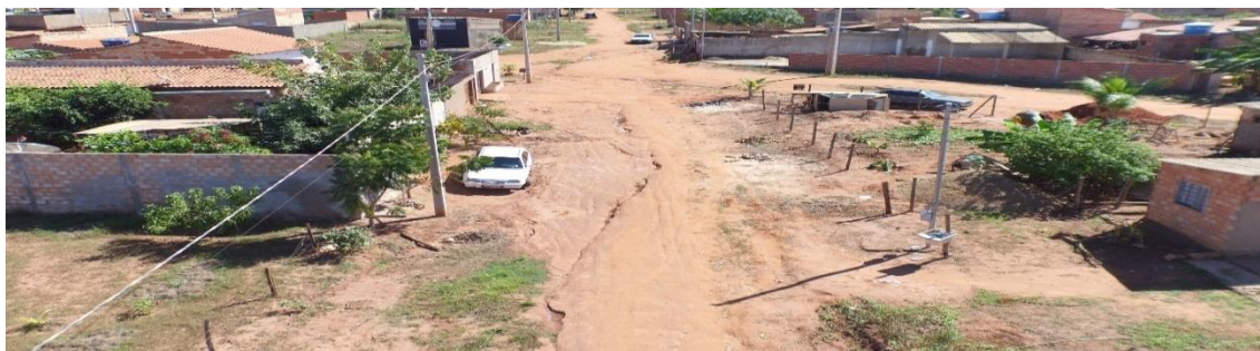
Figura 14 –Nova Era, em 30/05/2020 – rua com pequena erosão
