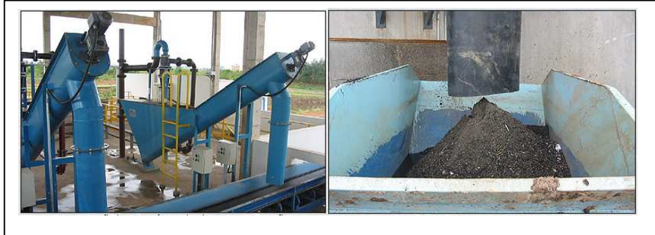
Figura 13 – ETE Goiânia: lavador de areia Fonte: SANEAGO (2010a.)
