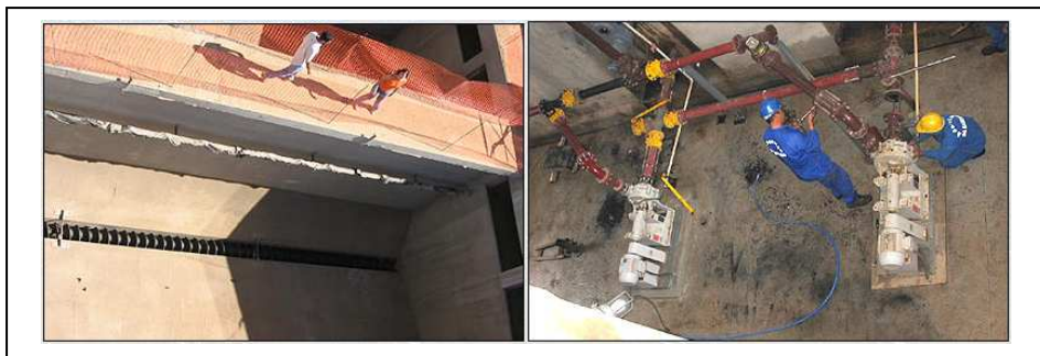
Figura 12 – ETE Goiânia: caixa de areia aerada/recalque Fonte: SANEAGO (2010a.)
