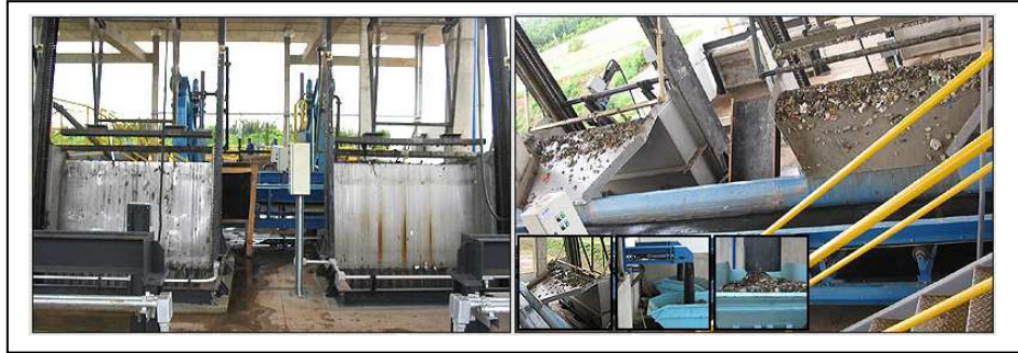
Figura 10 – ETE Goiânia: tratamento preliminar/gradagem Fonte: SANEAGO (2010a.)
