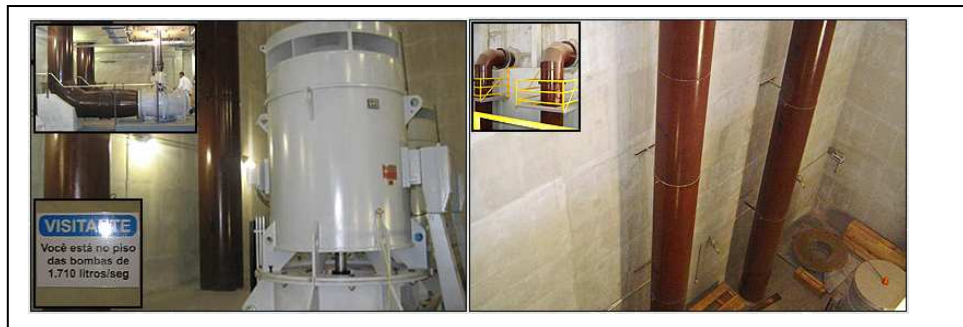
Figura 9 – ETE Goiânia: estação elevatória de esgoto bruto/recalque Fonte: SANEAGO (2010a.)
