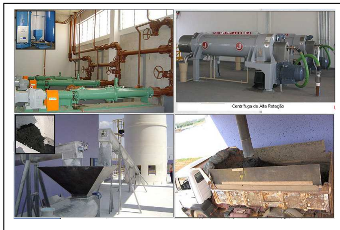
Figura 16 – ETE Goiânia: tratamento do lodo Fonte: SANEAGO (2010a.)
