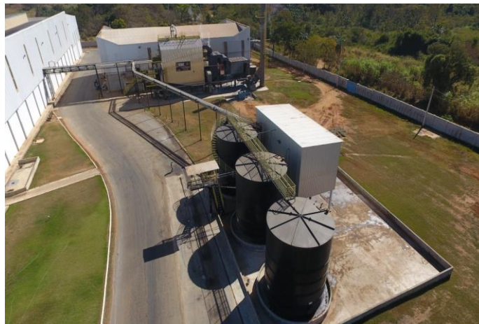
Foto 3 - Caldeira de biomassa e tanque de armazenamento na empresa Goiás Rendering
