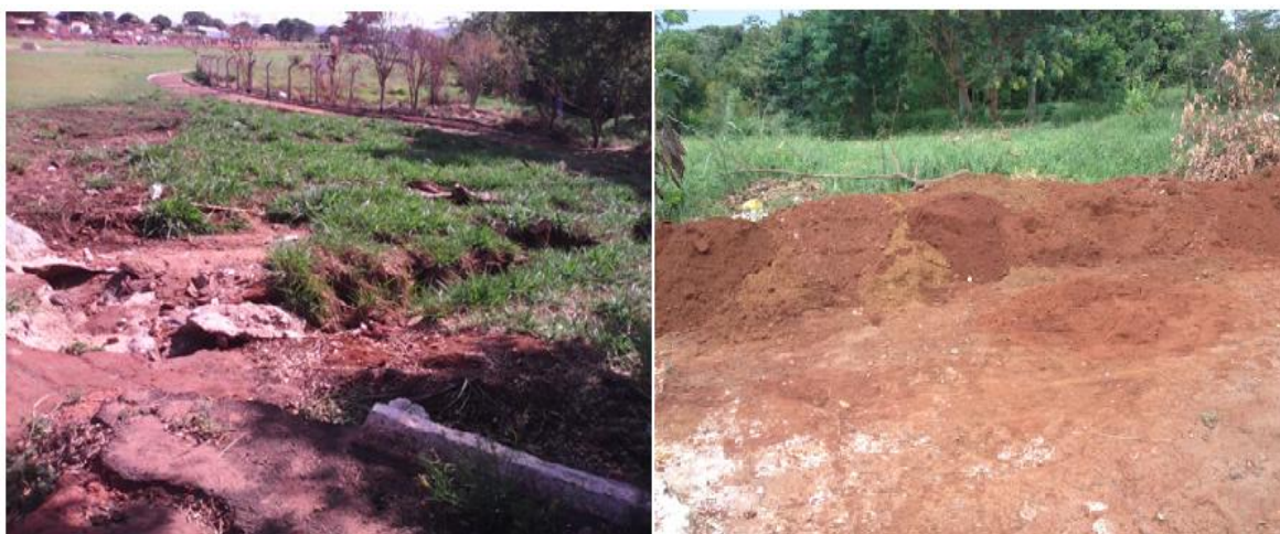
Figura 25 – Princípio de processo erosivo na cabeceira do córrego Veredinha
