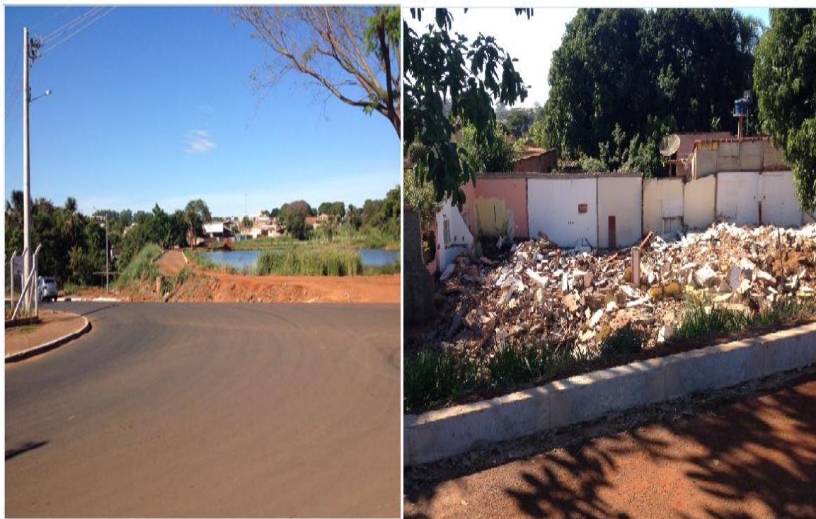
Figura 17 – Obras e desapropriações na cabeceira do córrego Chapadinha
