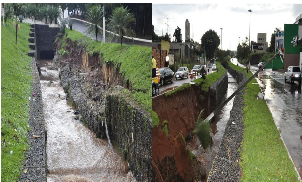
Figura 11 – Deslizamento das margens do córrego Barrinha
